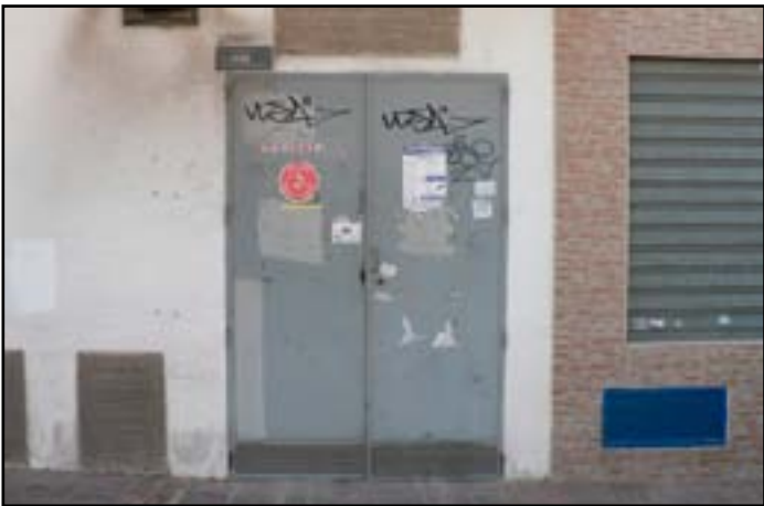
Transformador en calle Pilar.
